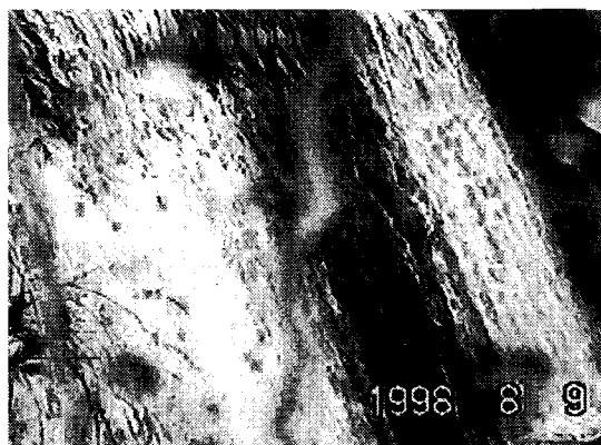
大雨のため擁壁から流れ出る雨水 (S波が流れ込み?)
